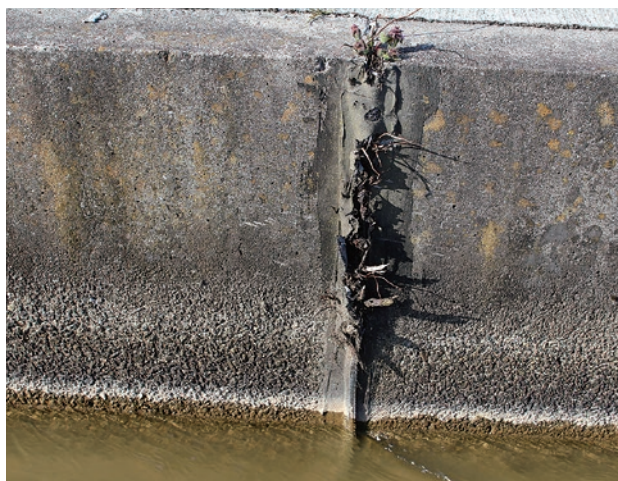
経年劣化によりひび割れた目地の状況
