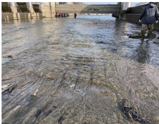
エプロン部分洗掘状況（鉄筋露出）
