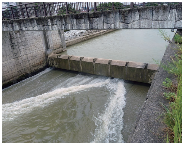
土砂吐ゲート全閉不能状況
