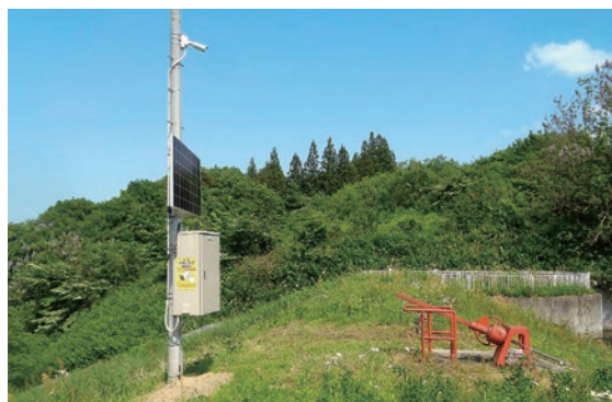
中郷地区 大和沼 監視カメラ設置
